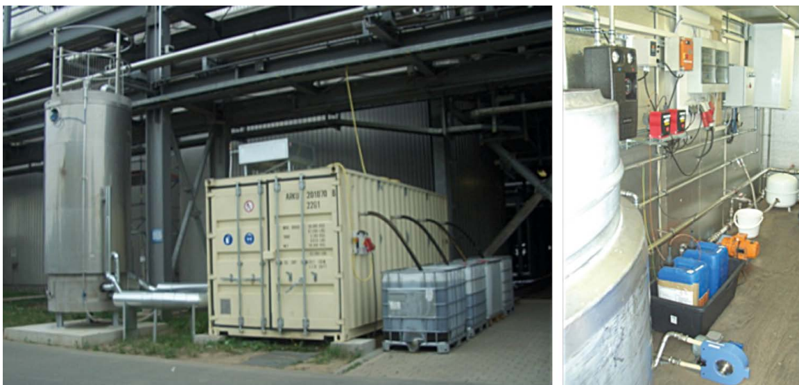
Abbildung 15: Pilot-Biogasanlage auf dem Gelände der Crop Energies AG. Links: 6 m 3 -Fermenter, Technikcontainer sowie Gärrest-IBCs. Rechts: Innenansicht des Technikcontainers mit Substratdosierung, Armaturen, Rohrleitungen und Additiven.
