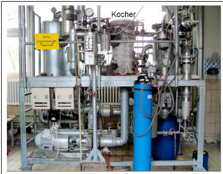
Abb. 46: Versuchsanlage Uni-HH/TI (Quelle: BTS)
