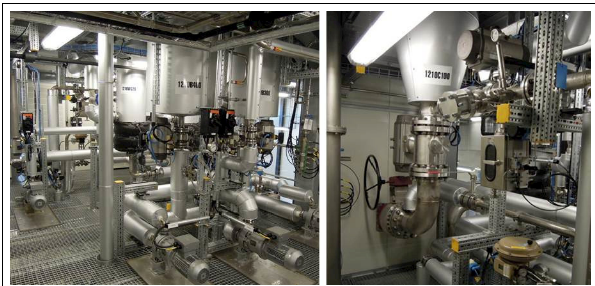
Abb. 72: TA 1210 Holzaufschluss. Links: Druckvorlagebehälter B400 und B300 mit Umwälzpumpen und Rohrbündelwärmetauscher. Rechts: Laugenzirkulationsleitung mit Probenahme sowie Bodenventile des Aufschlussreaktors C100, Blasleitung für die Entleerung der Cellulosefraktion in die TA 1240 (Quelle: CBP)
