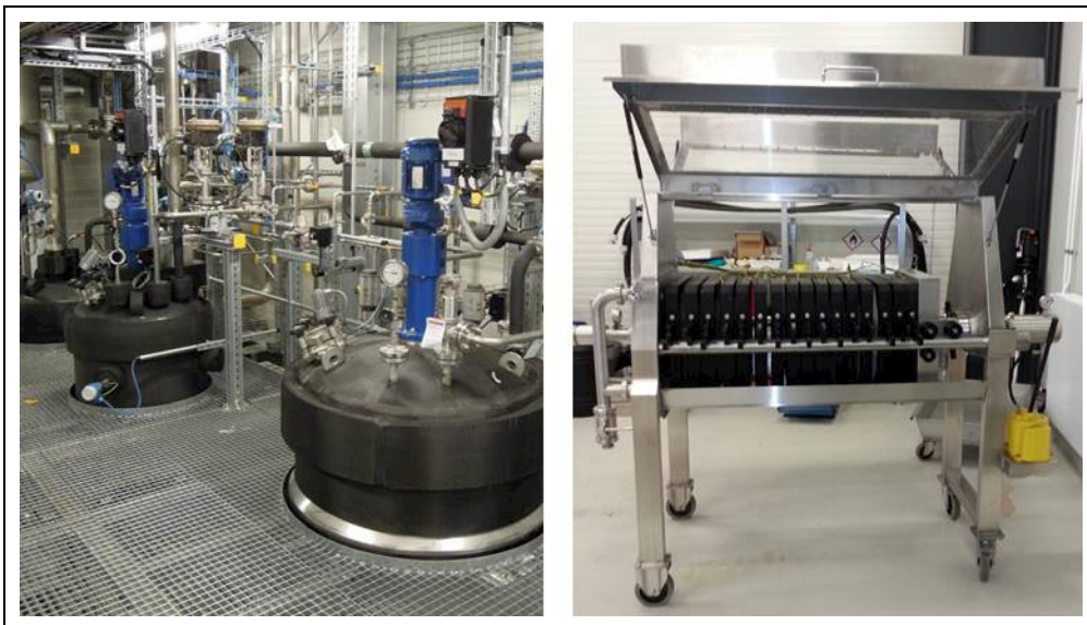
Abb. 73: Links: TA 1220 Ligninfällung mit den Fälltanks B200 und B100. Rechts: TA 1230 Ligninfiltration (Quelle: CBP)
