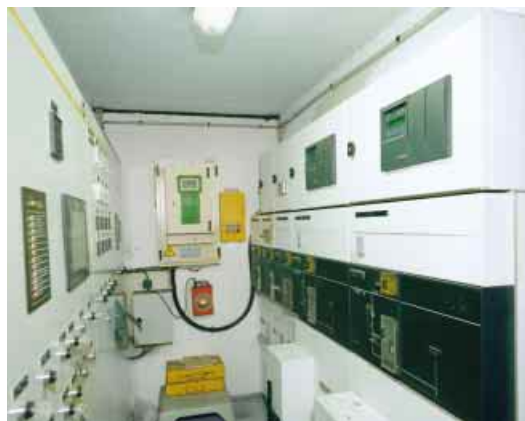
Les cellules HTA de la centrale de cogénération.
