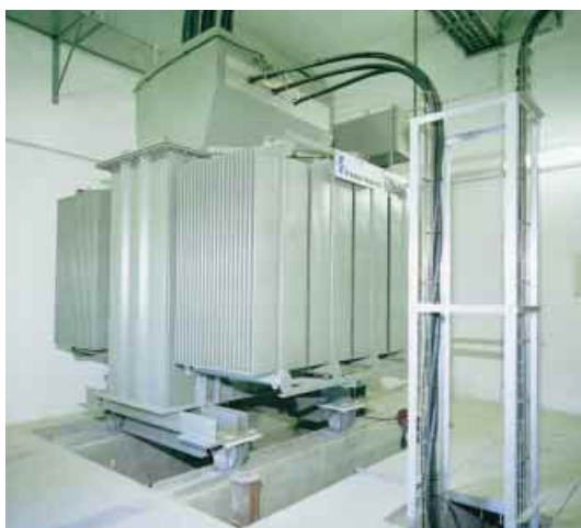
Le transformateur élévateur France Transfo 5,5 kV/20 kV, 10 000 kVA.
