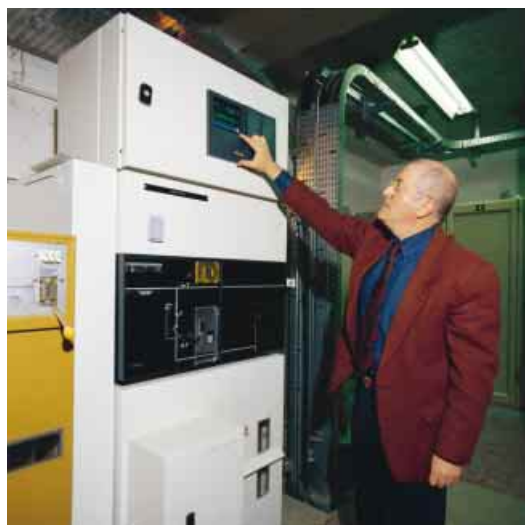
La cellule disjoncteur du poste de livraison et la protection Sepam.
