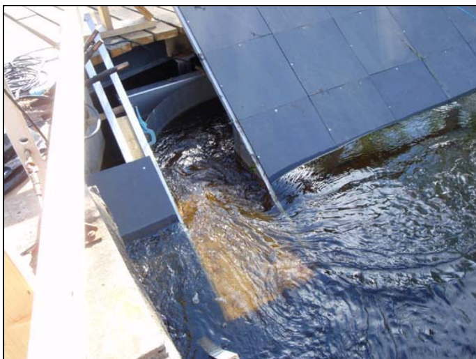
Foto 5.1 Intagsgaller med en sluss i ytan där fiskmigration kan ske. Vattenkraftverk i Emån, övre Finnsjö.
