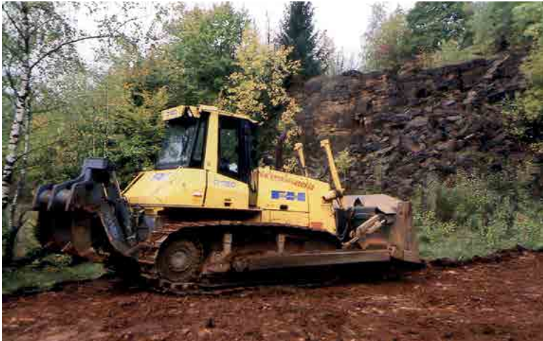
Abb. II.238: Bei den in den stillgelegten Erzgrubengebieten vorhandenen, steinig Böden, besteht beim Einsatz schwerer Maschinen kaum eine Verdichtungsgefahr des Untergrundes. (NSG Léiffrächen 18.10.2013; Foto: Josy Cungs).
