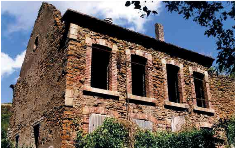
Abb. II.195: Vorderer Bereich des zurzeit stark verfallenen Industriegebäudes auf Didelstergrond. Die im NSG Haardt zwischen Hesselsberg und Perchesberg gelegenen Ruinen könnten im renovierten Zustand z.B. während der Beweidungsdurchgänge als temporärer Unterstand für die Schaf- und Ziegenherde mit einem Aufenthaltsraum für den Schäfer genutzt werden. Des Weiteren könnte ein polyvalenter Empfangsraum sowie Büroräume für Studenten und ein Pädagogikraum mit Laboratorien eingerichtet werden. Mitte August 2008 wurden erste zaghafte Schritte in dieser Hinsicht realisiert. (Didelstergrond, NSG Haardt, 04.08.2008; Foto: Josy Cungs).
