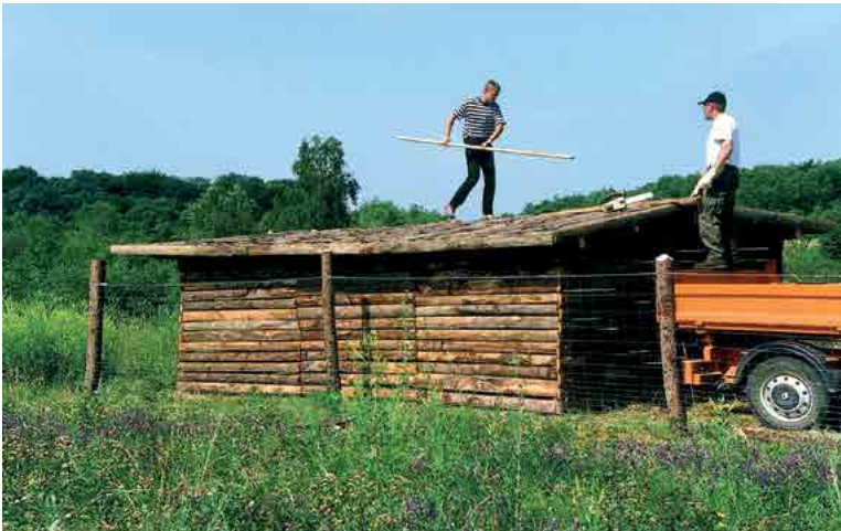
Abb. II.189: Errichtung eines ersten kleinen Unterstandes für die Schaf- und Ziegenherde. (NSG Haardt 22.06.2005; Foto: Josy Cungs).
