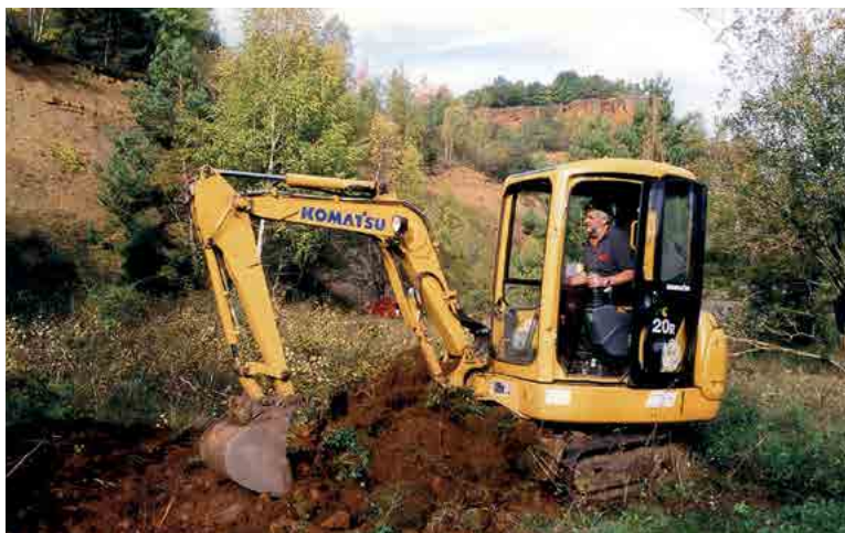
Abb. II.6: Je nach Geländegängigkeit und Flächenausdehnung der teils sehr dichten Stockausschlag- und Wurzelbrutbestände der Zitter-Pappel ( Populus tremula ) wurden diese gelegentlich versuchsweise mit dem Kleinbagger entfernt. Diese Arbeitsweise garantierte eine ergiebige Wurzelentnahme, die somit Wiederausschlag fast vollständig verhinderte. (NSG Léiffrächen 07.10.2009; Foto: Josy Cungs).
