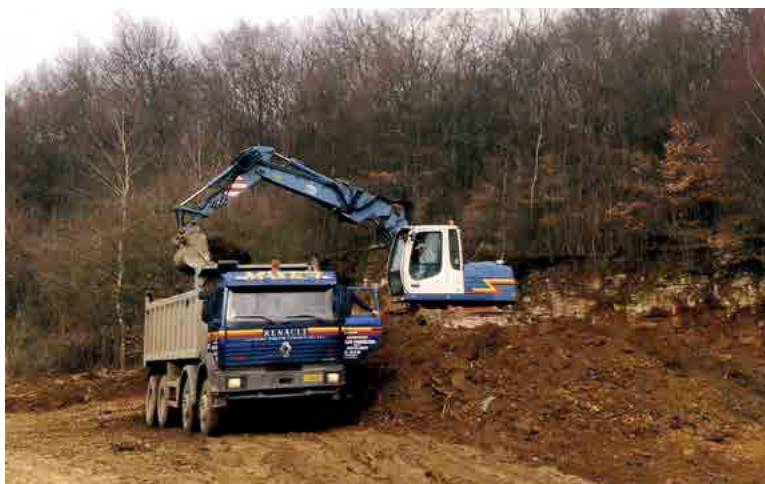
Abb. III.17: Enorme, in der Erdmasse auftauchende Mengen an Eternitabfällen erschwerten die Sanierungsarbeiten erheblich, da diese speziell gelagert und entsorgt werden mussten. Zudem wurde die nicht mehr sichtbare, südexponierte Abbruchkante freigestellt. (NSG Haardt 20.03.2006; Foto: Josy Cungs).
