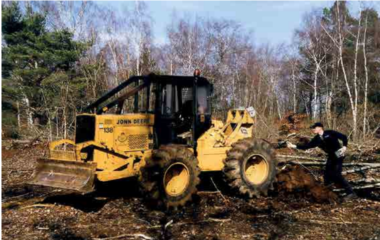
Abb. II.4: In einer Phase, in der nach geeigneten Entbuschungsmethoden gesucht wurde, kam auch eine Holzrückemaschine versuchsweise zum Einsatz. (NSG Haardt 15.03.2006; Foto: Josy Cungs).
