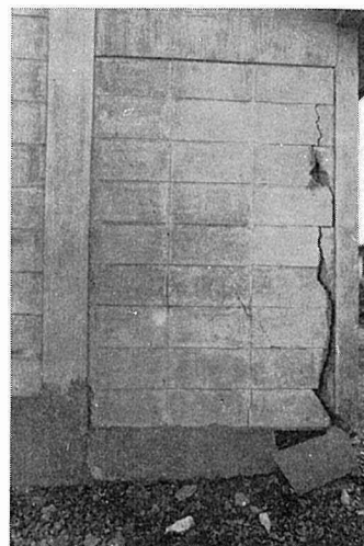
写真-2 桂木団地壁の損傷
