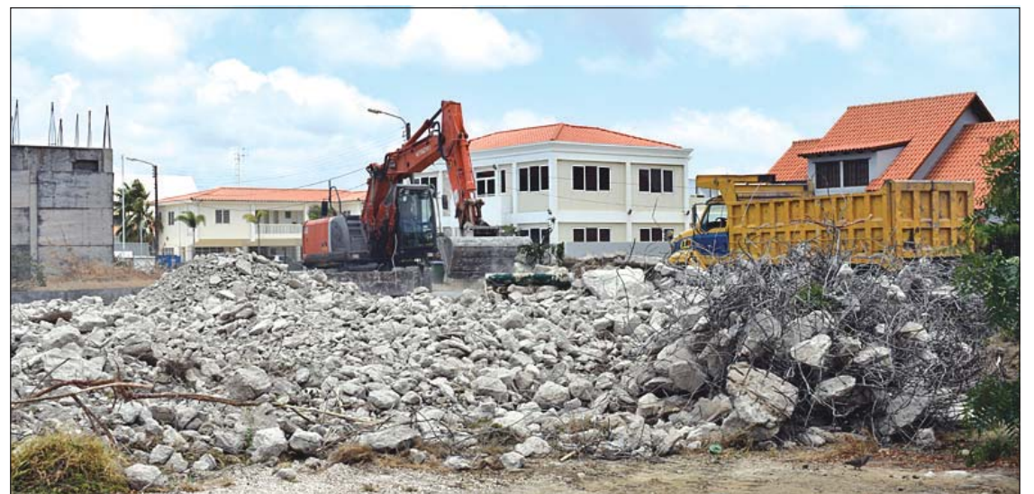
Djasabra a basha un edifisio ku pa basta aña tabata 'den konstrukshon' abou. Ta trata di e mitar konstrukshon pabou di ofisina di notario Aniek Schouten. Fotonan ta muestra momentu ku ekipo pisa tabata eliminando e mahos bista aki.
