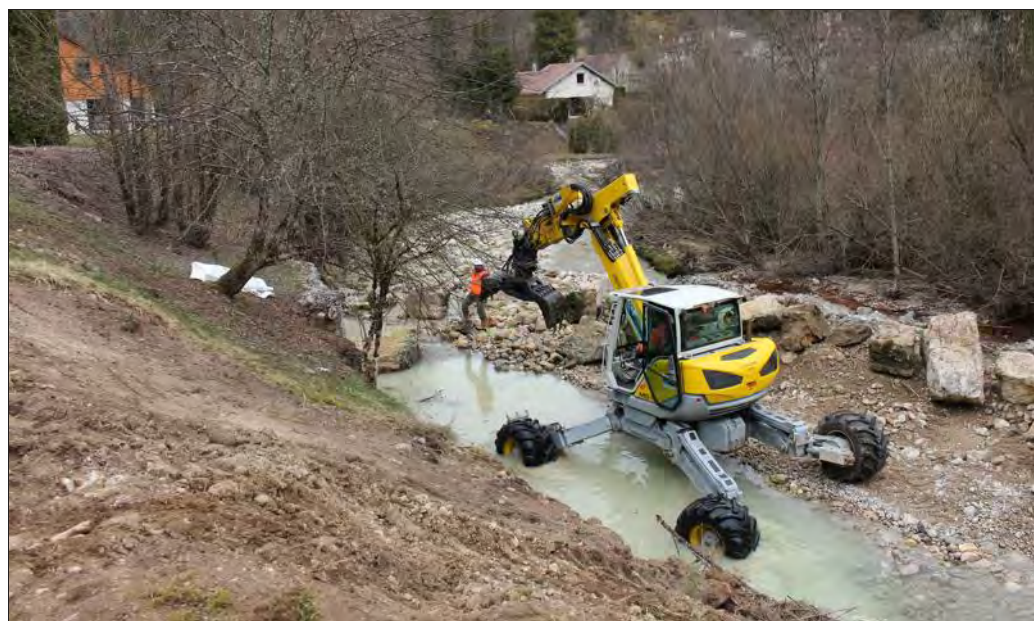
L'enrochement réalisé il y a plusieurs années n'a pas résisté aux dernières crues. Des glissements de terrain ont été signalés, il était donc urgent d'agir. Photo Progrès/Jamila CHAFII
