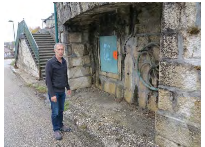
Le mur de soutènement en dessous de la mairie présente des fissures importantes, constat fait par Pascal Courtois, maire. Photo Progrès/Yves BOURRIER
