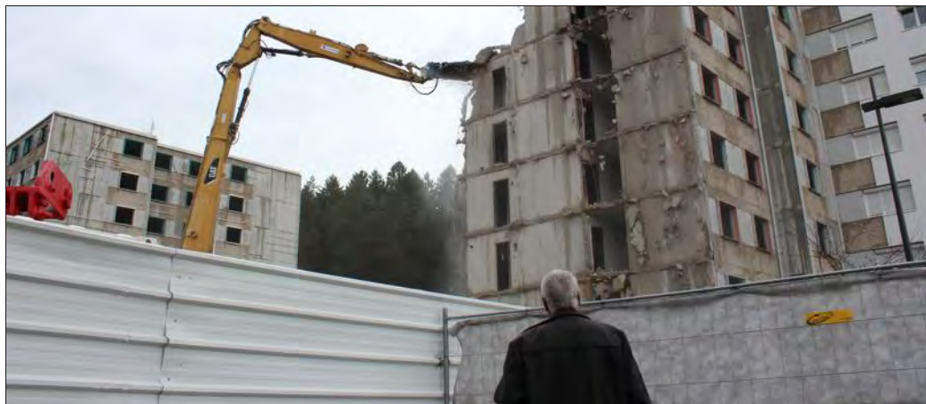
Le grignotage des trois immeubles de la rue Saint-Exupéry avait duré plusieurs jours.
