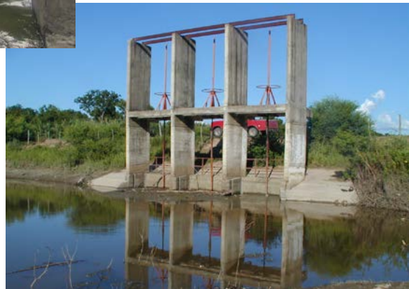
Figura 22. Alcantarillas sobre el curso del río Porteño, el cual posee comunicación indirecta con el Bañado. El paso del agua por las mismas está regulado a través de compuertas (Foto: Claudio Baigún)
