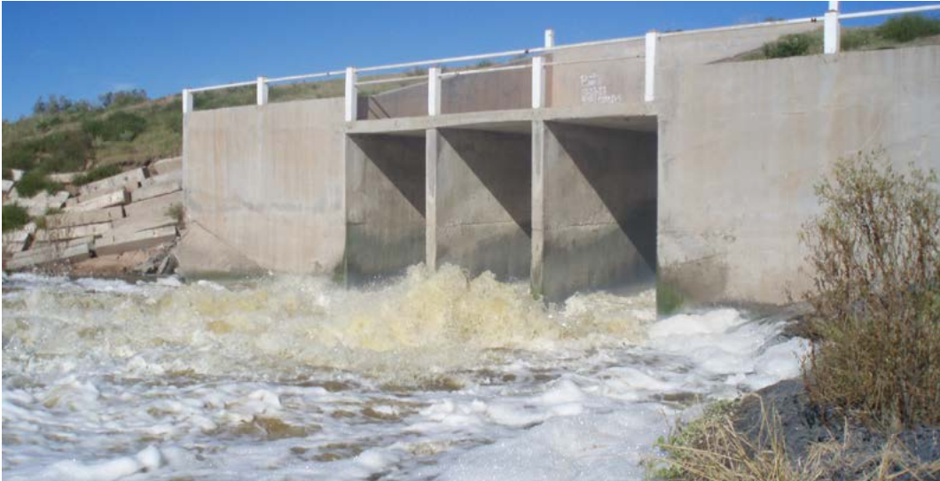
Figura 25. Vanos del río Salado que comunica el sector del bañado La Estrella aguas arriba de la ruta 28 con la cuenca inferior. Las condiciones hidráulicas y de diseño de los vanos impiden el ascenso de los peces que intentan migrar hacia aguas arriba
