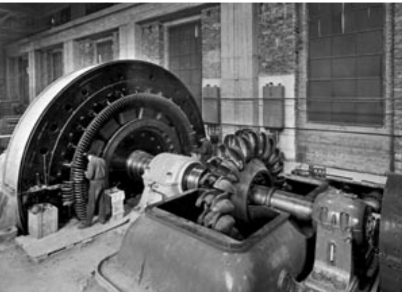
Turbina e rotore della centrale di Ganda. Foto archivio Edison
