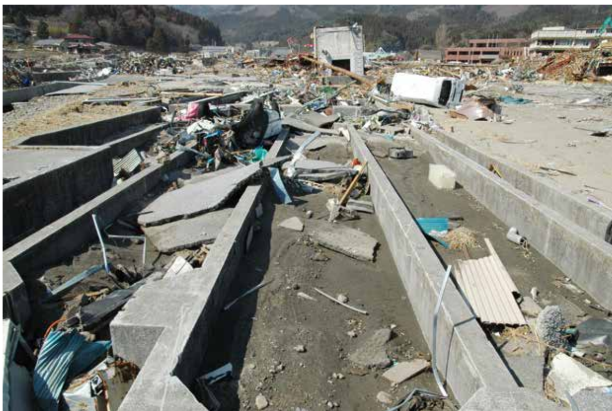
第12図 東日本大震災で被災したサケの孵化施設。2011年4月撮影 岩手県では28カ所の孵化施設の内21カ所が震災により壊滅状態となった。
