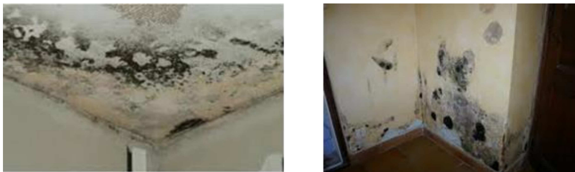
Figure 30 : Traces de moisissures dans un angle correspondant à un pont thermique (à gauche) et à une remontée capillaire (à droite)
