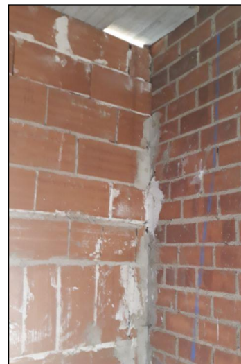
Fig. 3: La falta de enjarje puede ser motivo de fisuraciones. El encuentro entre ladrillos de distinto formato y características aumenta ese riesgo. En la imagen se aprecian trabas defectuosas y la colocación de algunos LHD en sentido vertical.
