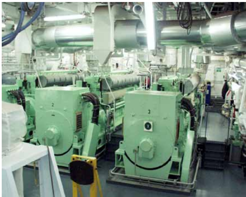
Siłownia statku 8168/1 Na pierwszym planie silniki spalinowe napędzające prądnice Elektr. (3 szt.)
