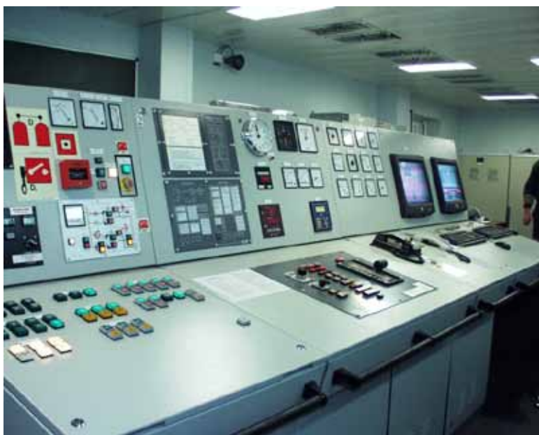
Najważniejsze miejsce w siłowni statku. Centrala Manewrowo Kontrolna (w skrócie CMK)
