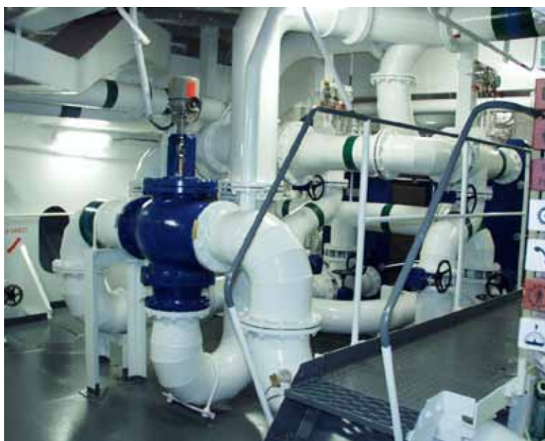
To też praca siłowniarzy, z pracowni TKS statek 8168. To fragment orurowania systemu chłodzenia Silnika Głównego i zespołów prądotwórczych.
