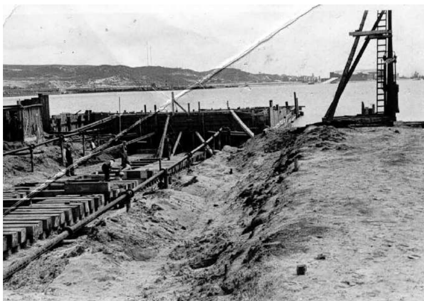
Budowa pochylni nr 1. Widok od strony hali kadłubowej. (Fotka ze zb. inż. Zb. Nowaka)
