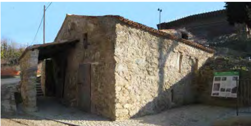
Fig. 3 (a destra) – Fornace Malpezzi: il cantiere di restauro e consolidamento strutturale. Dicembre 2010 (foto T. Conti, S. Galegati).
