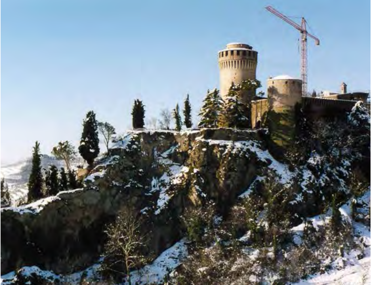
Fig. 28 – Restauro della Rocca e consolidamento del versante orientale del colle. Inverno 2002-2003 (foto S. Piastra).
