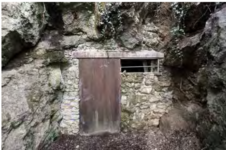
Fig. 6 – La chiusura realizzata all’imbocco artificiale della Tanaccia (Archivio Life+ 08/NAT/IT/369 “Gypsum”; foto F. Grazioli).
