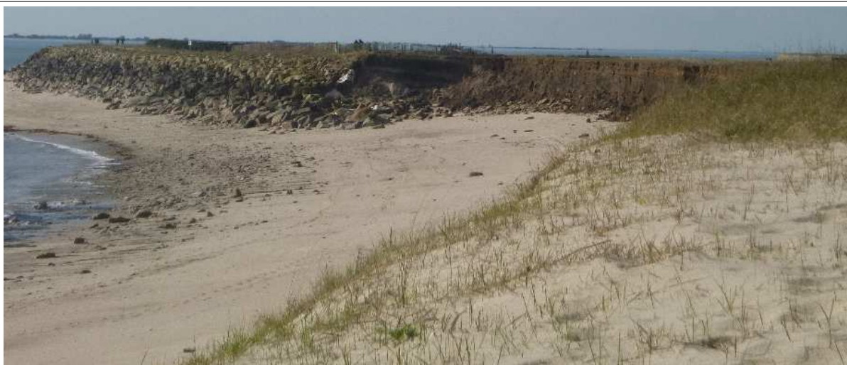
Exemple d'érosion à l'extrémité d'un ouvrage en enrochement – cordon dunaire à Treffiagat (février 2016 ©Cerema)
