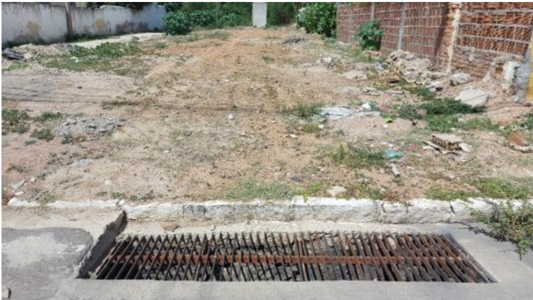
Figura 124 – Boca de Lobo simples próxima a lote vago com ausência de cobertura vegetal Fonte: INSTITUTO GESOIS, 2020.
