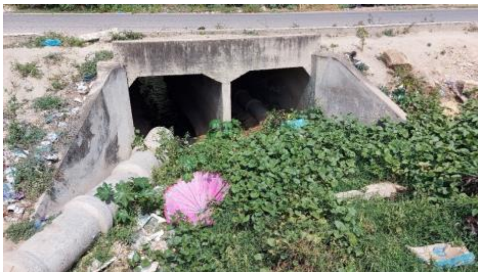
Figura 126 – Obra de macrodrenagem sem a devida manutenção Fonte: INSTITUTO GESOIS, 2020.
