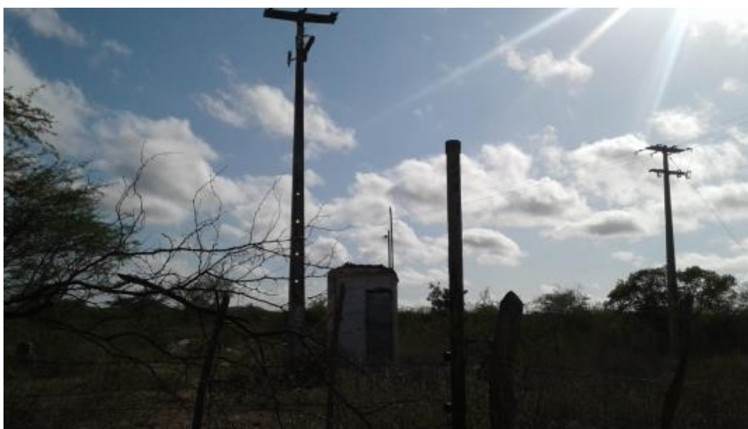
Figura 42 – Poço Bairro Boa Vista Fonte: INSTITUTO GESOIS, 2021.
