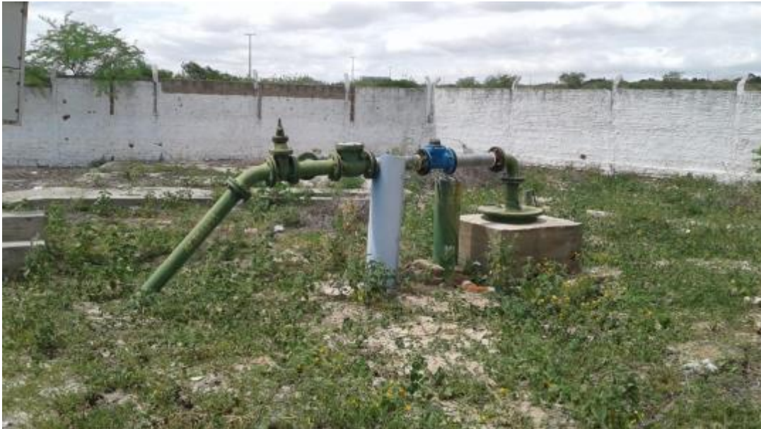
Figura 37 – Poço C2 SAA COMPESA Fonte: INSTITUTO GESOIS, 2021.
