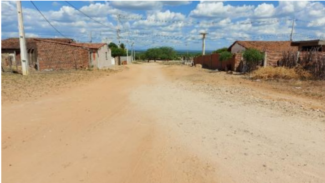
Figura 134 – Agrovila IV com ausência de sistema de drenagem Fonte: INSTITUTO GESOIS, 2020.
