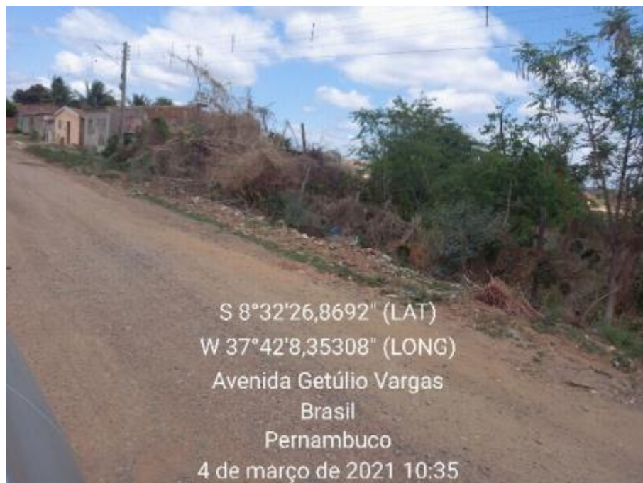
Figura 106 – Falta de Capina. Fonte: INSTITUTO GESOIS, 2021.
