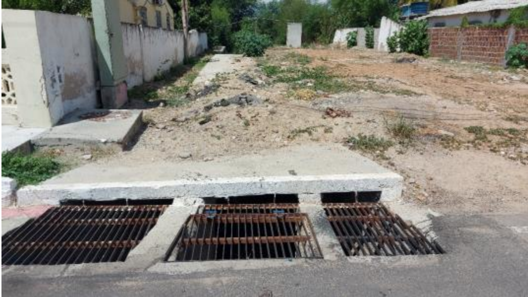
Figura 123 – Boca de Lobo tripla próxima a lote vago com ausência de cobertura vegetal Fonte: INSTITUTO GESOIS, 2020.
