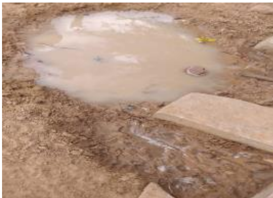
Figura 61 – Esgoto do Sítio Salgado Fonte: INSTITUTO GESOIS, 2021.
