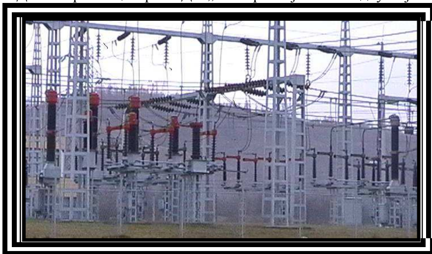
Слика бр. 23 : 110/35 kV (ТС) постројење у Беглук пољу
