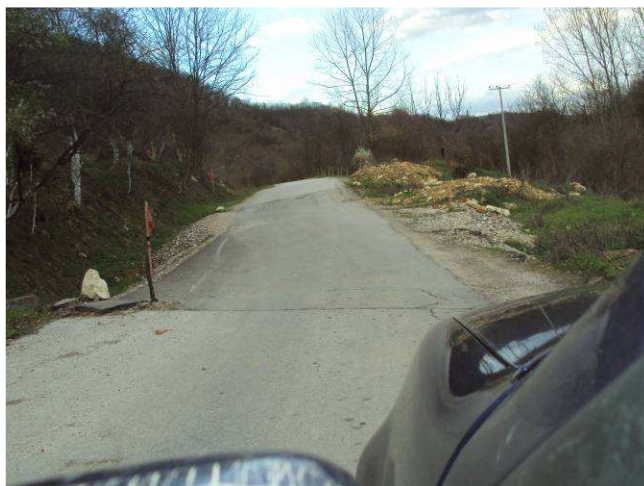
Слика бр. 12 : Клизиште на локалном путу за Горњи Локањ
