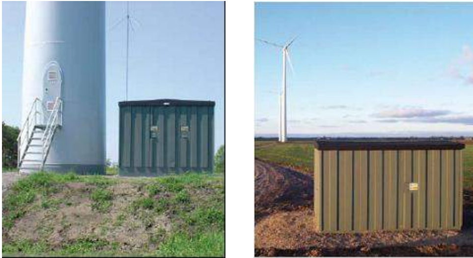
Figur 4-5. Två exempel på mindre kopplingsstationer som ligger i anslutning till respektive vindkraftverk.
