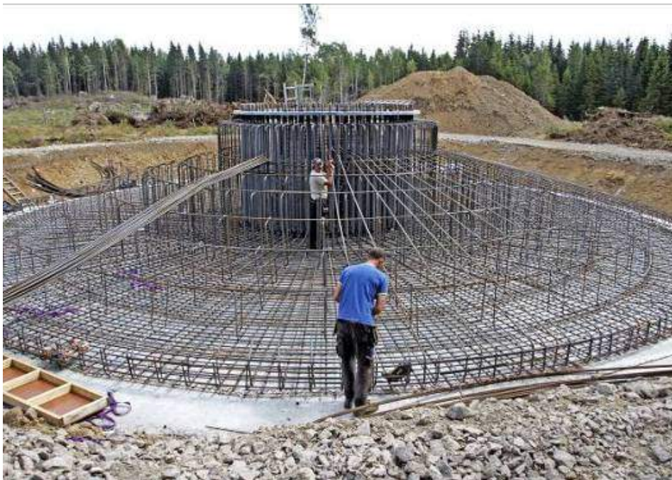
Figur 4-6. Armering av gravitationsfundament för vindkraftverk vid Ryningsnäs i Hultsfreds kommun (foto Hans Blomberg).
