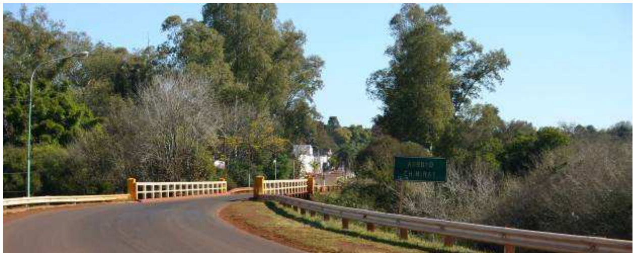
Foto 2.3.1.3-1. Ponte sobre o Arroio Chimiray, limite entre Misiones (Apóstoles) e Corrientes (Colonia Liebig), sobre R. Provincial 71 (S 27°54'67,9" – WO55°48'94,8")
