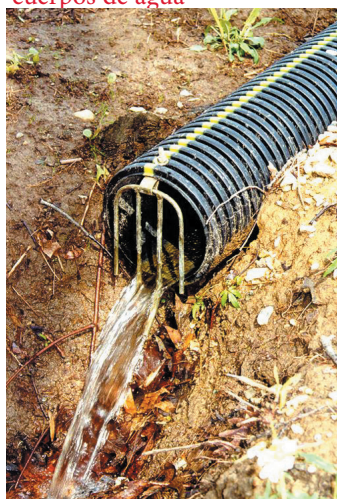
Los extremos de las líneas de drenaje deben ser protegidos para evitar que los animales entren la tubería.
