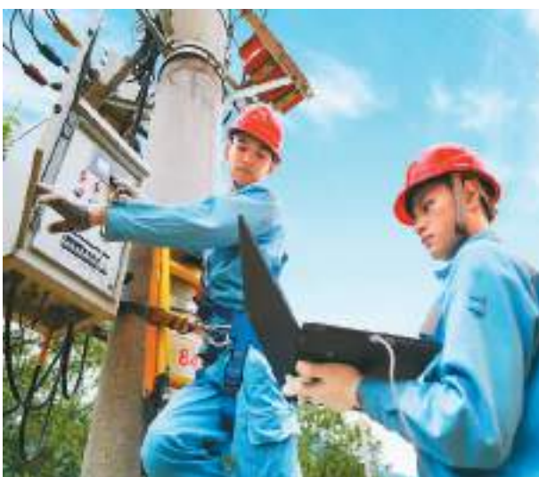
为保障企业和群众冬季用电，南方电网贵州铜仁江口供电局工作人员对所辖线路运行正常。吴瑾摄（人民视觉）
