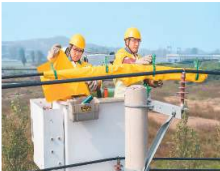
随着今年迎峰度冬时段到来，国网山东省兰陵县供电公司组织电力工作人员到辖区开展电网秋检工作，对老旧设备进行检修消缺、升级改造，确保电网平稳运行和供电安全可靠。图为电力工作人员正对供电设备进行检修。
