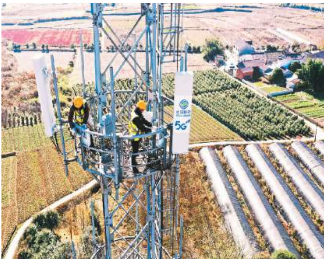
▲在安徽省铜陵市义安区钟鸣镇，安徽移动铜陵分公司技术人员在进行5G基站设备更新升级。
