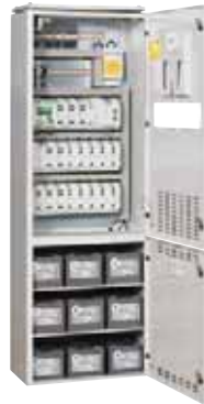
CEAG Notlichtversorgungsgerät (Ex-freier Bereich)
