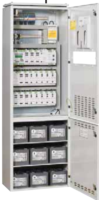
CEAG-Notlicht-Versorgungsgerät (Ex-freier Bereich)
