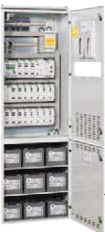
CEAG-Notlichtversorgungsgerät (Ex-freier Bereich)
