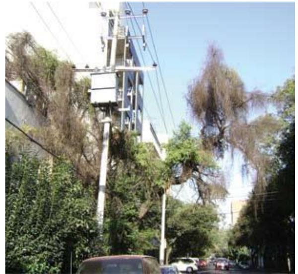
Estado avanzado de infestación
