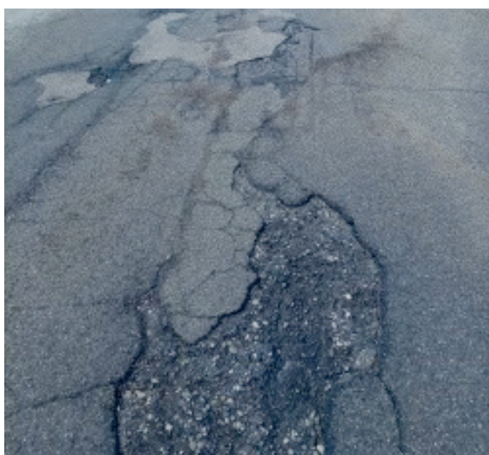
Alcune delle buche di via Asilo, secondo tratto
