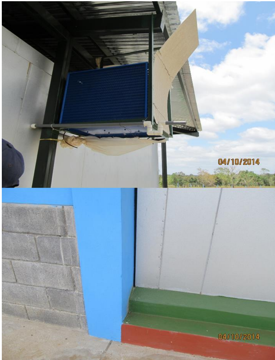
Figura No. 60. Fotografías mostrando un cuarto frío y áreas laterales sin protección contra los fenómenos climáticos. Equipos de enfriamiento al aire libre, fisuras laterales que permiten la invasión y anidamiento de plagas y enfermedades en los alrededores de la planta de acondicionamiento. Fotografías Néstor Bonilla Bird.
