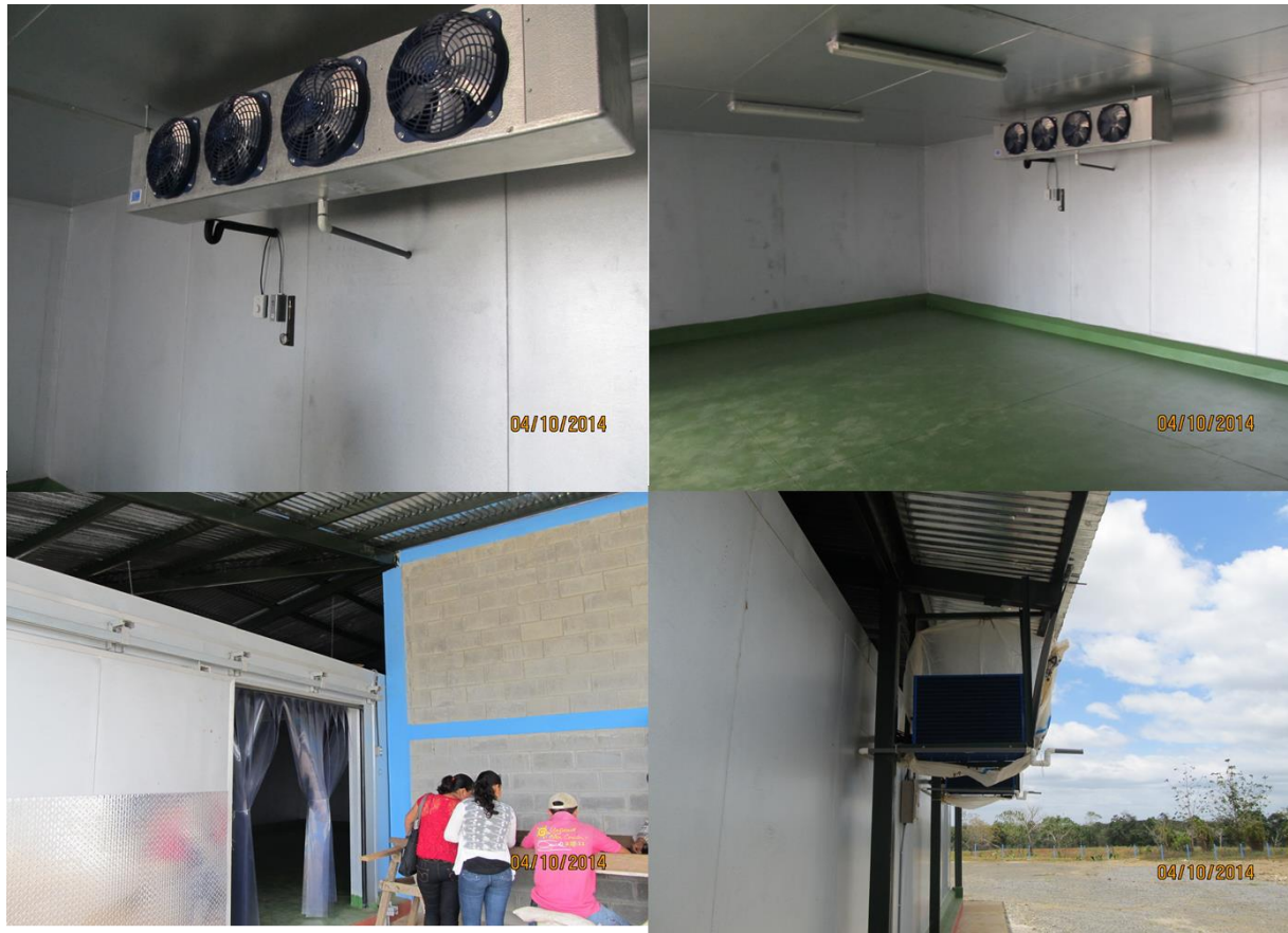
Figura No. 53. Cuarto frío para la conservación de semillas de granos básicos, en Nueva Guinea- RAAS. Foto superior izquierda unidades del deshumidificador, superior derecha vista de piso aislante y cuarto completamente sellado. Inferior izquierda, entrada a cuarto frío con aislantes flexibles para detener el intercambio de temperaturas con el exterior. Inferior derecha, unidades externas de enfriamiento. Fotografías Néstor Bonilla Bird.
