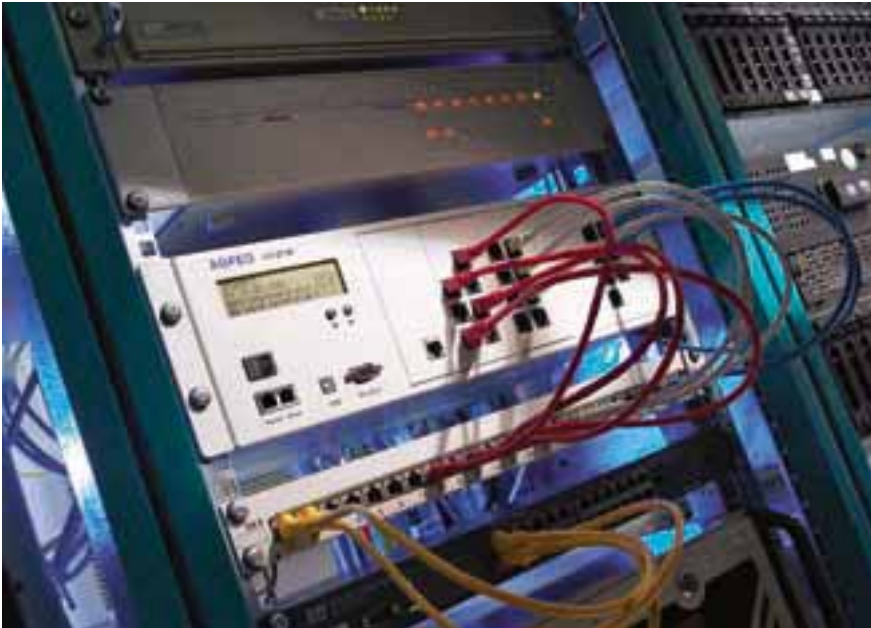
KOMPAKT: Telefonanlagen als 19-Zoll-Racksysteme finden in jedem Serverschrank Platz.
