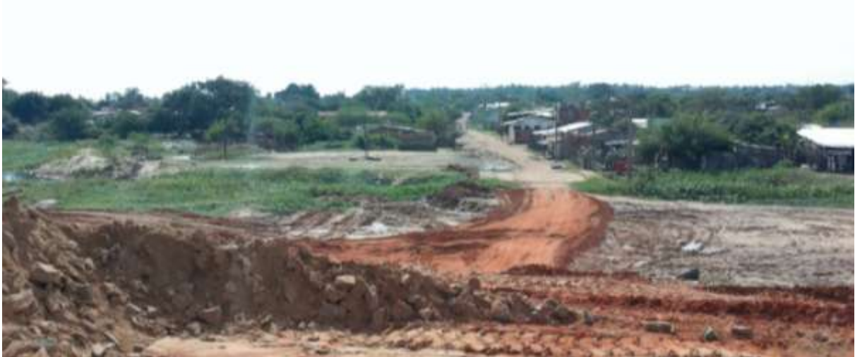
Ilustración 112 Fotos del terraplén de la prolongación de la calle 1°Presidente desde la rotonda de la Avenida Costanera
