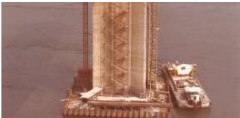
Ilustración 30 Recinto de tablestacas utilizado para la ejecución de pila central del Puente del Remanso.
