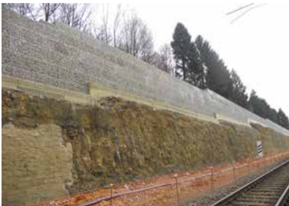
_Murs de soutènement en gabion en crête et mur de confortement en maçonnerie en pied de paroi
