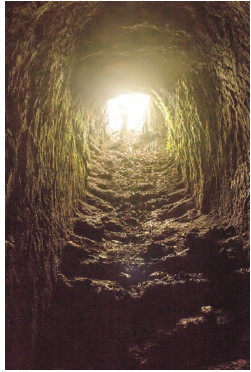
Figura 16 – Interior de Galeria oblíqua. Notar vestígios de degraus já erodidos.
