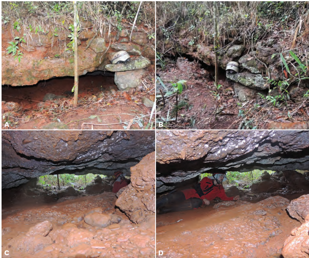
Figura 15 - Entrada da cavidade CCA51. Destaca-se a espessura do maciço na entrada da cavidade, bem como a presença de arrimo na lateral da entrada da cavidade. Fotos: Fernanda Souza (2015, 2016)
