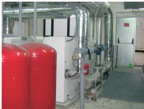
Vista general de la nueva sala de calderas.
