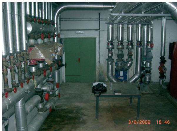
Se puede apreciar que la Sala de Calderas funcionaba como entrada al C.T., ubicado detrás de la puerta verde.
