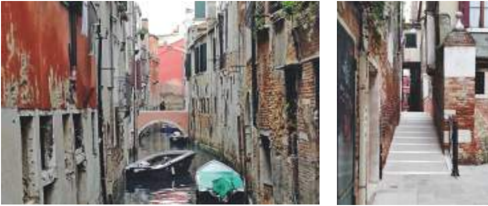
Fig.03 Ponte Raspi: prospetto del ponte dal rio delle Beccherie e vista del camminamento interno. Il ponte, ricostruito nel 1824 dopo averne abbattuto uno preesistente, è stato interessato da un intervento per l'accessibilità nel 2017 che ha modificato interamente la conformazione interna, eliminando le due rampe gradonate, sostituite da rampe a gradino agevolato. R.Revellini
