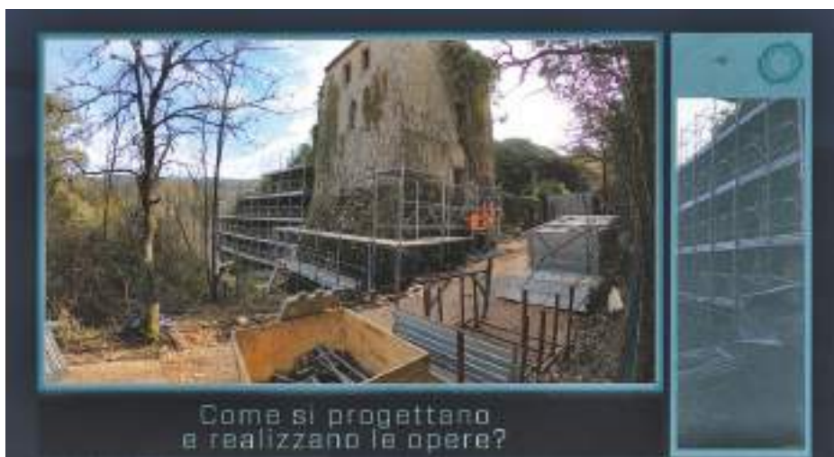
Fig.03 Fotogramma riguardante il montaggio dei ponteggi, che introduce alla serie di lavorazioni intraprese nel cantiere.
