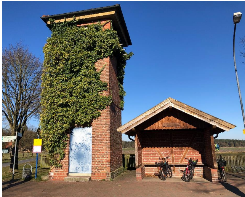
Abbildung 1: Transformatorenstation mit angrenzender Bushaltestelle. Quelle: Sweco GmbH
