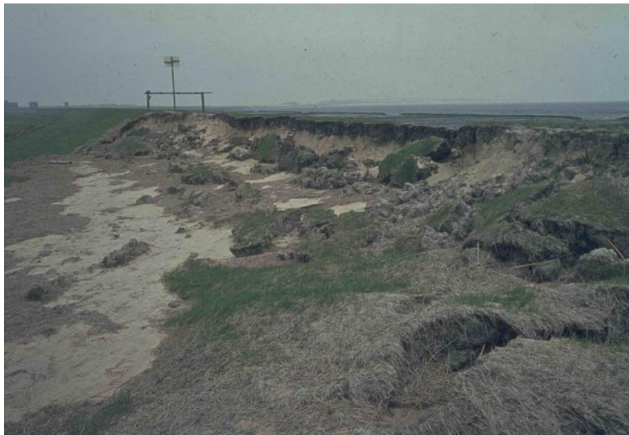
Abbildung 4: Deichbinnenböschung mit en-bloc-Rutschungen (Zitscher 1962).
