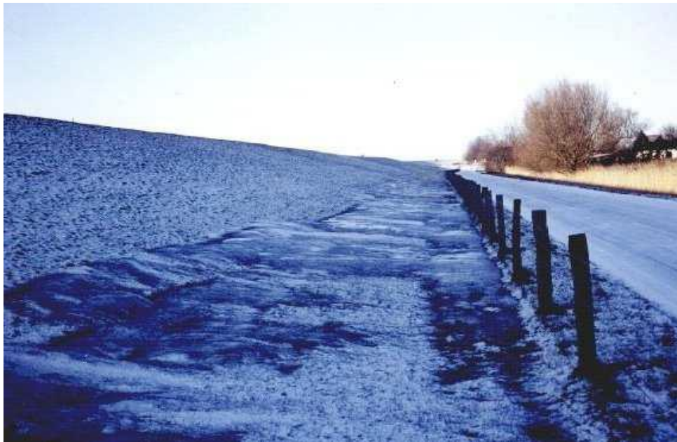
Abbildung 15: Fließerscheinungen am Innendeichfuß bei Neufeld-Nordhusen.
