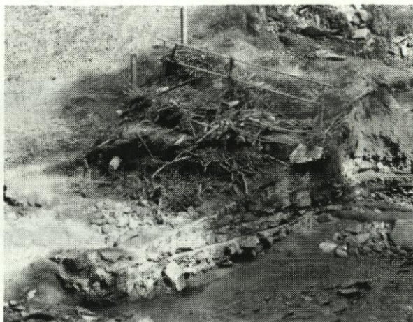
Abbildung 6 Einlauf des Durchlasses während und kurz nach dem Hochwasser 2002. Verklausung (Foto: Bornschein 2002)
