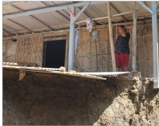
Gambar 3.5. Kondisi Rumah Warga yang bagian depan sudah 'nggandul' (tergerus) Longsor di Desa Sumurboto, Kecamatan Jepon (Sumber: http://www.krjogja.com diakses pada tanggal 11 Oktober 2018)
