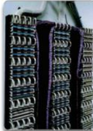
Infraestructura de armarios para el cableado
