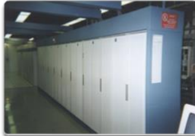
Grandes switches telefónicos
