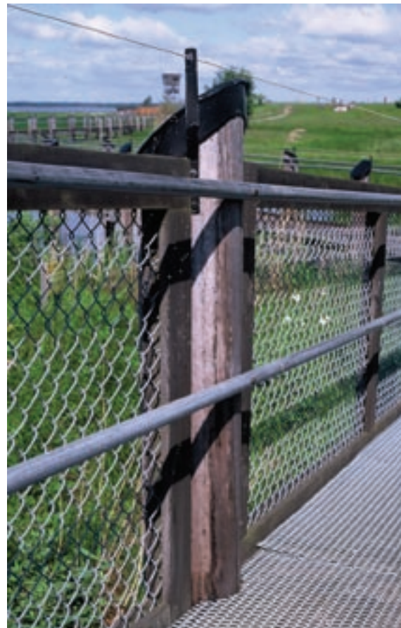
Ruotsin merkittävimmällä lintuvedellä (Hornborgasjön) on pitkospolkujen kaiteeseen lisätty kädensija pyörätuolilla liikkujan avuksi. Kaiteessa on vaijeri, joka estää mm. lokkilintuja jättämästä jätöksiä kaiteelle. Pitkospuiden pintaan on kiinnitetty teräsverkko, joka estää liukastumisen sateella. Kuva: Tiina Niikkonen.
