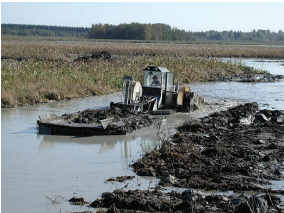
Siikalahden ruoppauksessa parannettiin vesilintujen elinolosuhteita. Ruoppausmassojen kuljetus on työlästä ja kallista, sillä massat tulee sijoittaa alueen ulkopuolelle. Kuva: Tiina Niikkonen.
