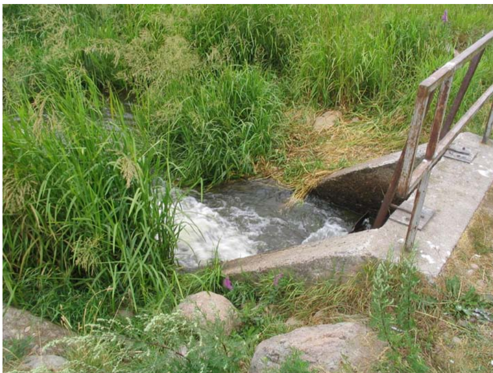
Kuva 9 . Lapinjärven luusuassa oleva pato.
