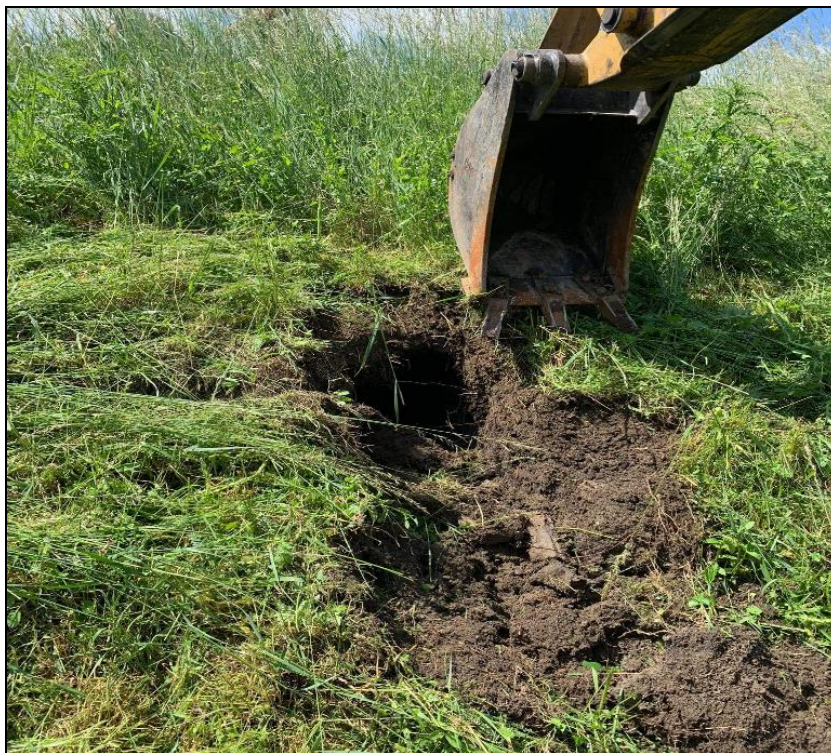
31. kép 10.11 árvízvédelmi szakaszon talált hódüreg feltárása
