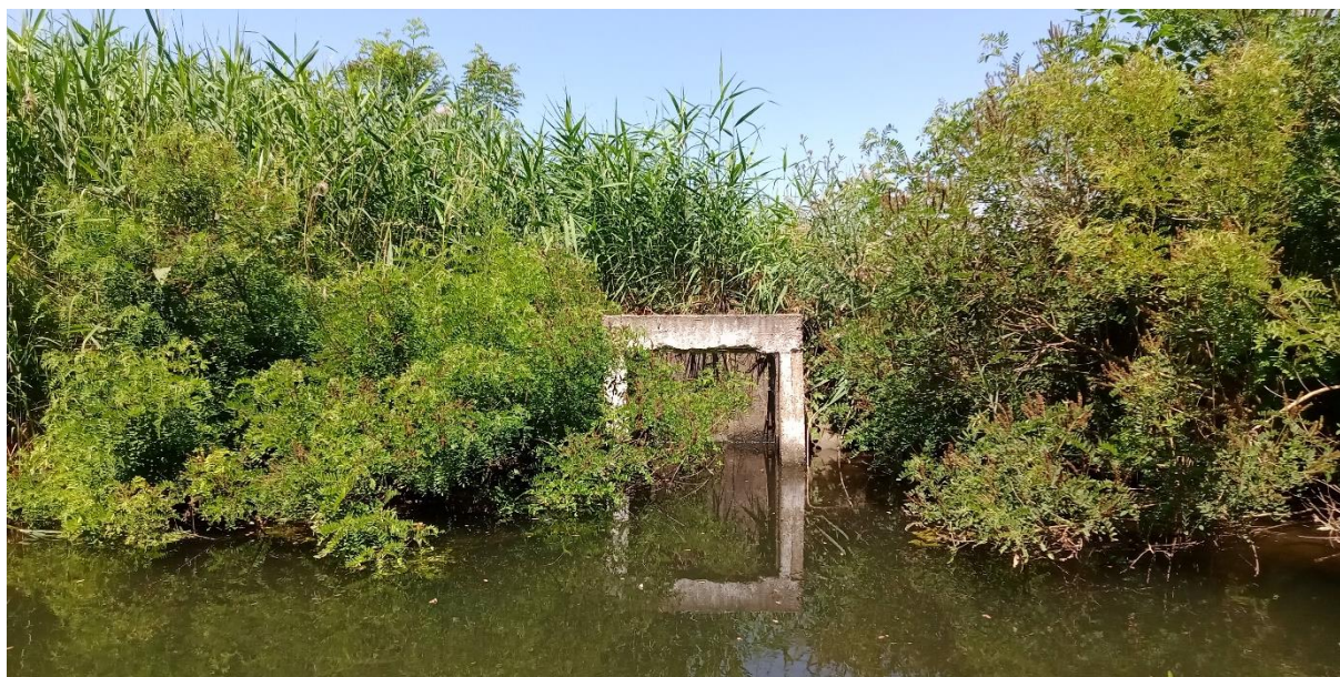
5. kép J-III-2-4 4+077 km szelvényben lévő műtárgy fix betétpallókkal.
