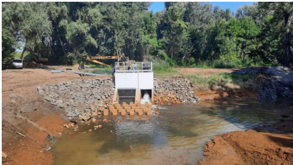
6. kép Tisza bp.158+350 tkm szelvényébe található szivornya alvízi csillapító műtárnya
