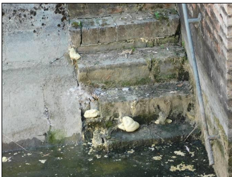
28. kép Az injektálás után megszűnő csurgás
