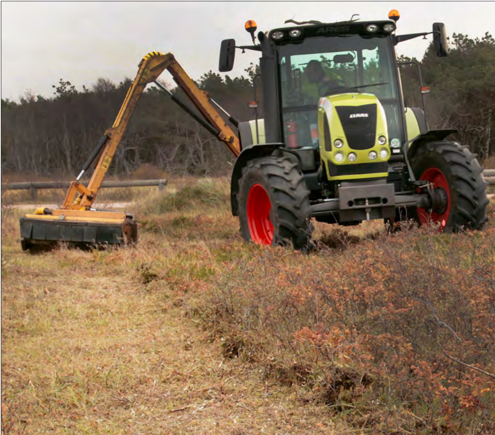
En enkel brandgata som klipps fram med "kanthack", ett redskap som används vid väggantsskötsel. Foto: Kill Persson.
