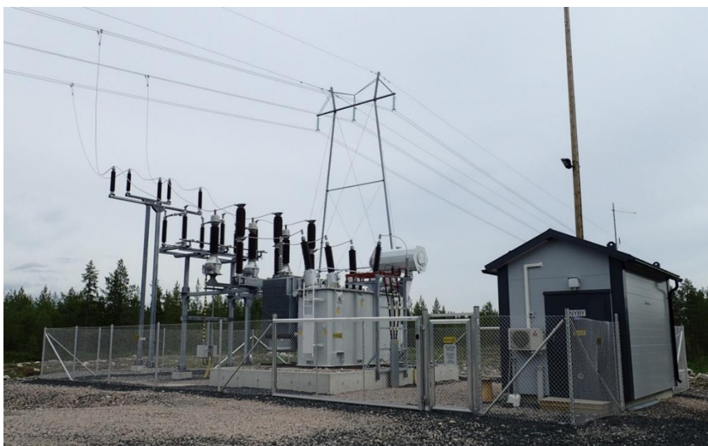
Kuva 9.7. Esimerkki tuulivoimahankkeen sähköasemasta (Minna Takalo, FCG).
