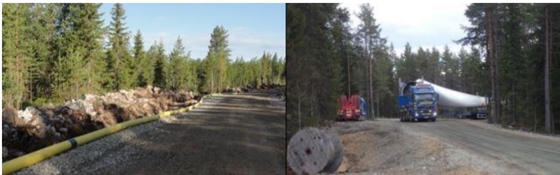
Kuva 9.8. Vasemmalla esimerkki tuulivoimapuiston rakennus- ja huoltotiestä. Teitä käytetään muun muassa betonin, soran ja voimaloiden komponenttien kuljetuksiin sekä tuulivoimapuiston käyttövaiheessa huoltoajoihin. Maakaapeli sijoitetaan ojakaivantoon tien reuna-alueelle. Oikealla tuulivoimalan osia kuljetetaan erikoiskuljetuksina. (Ville Suorsa, FCG).
