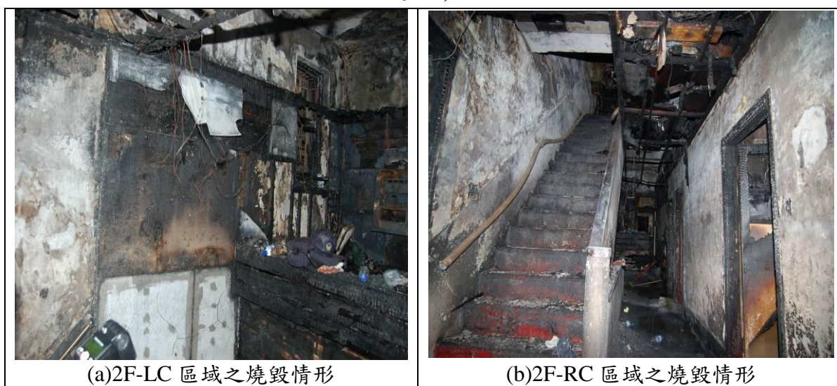
圖 9. 本案例 2 樓火災燒毀情形之照片圖 (資料來源:本研究拍攝)
