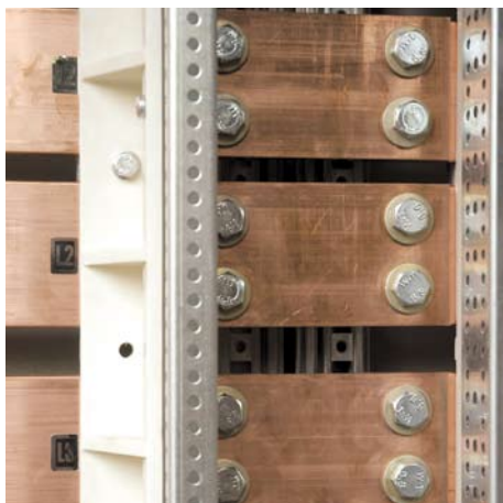
Wartungsfreie Sammelschienen-Verbindungen garantieren eine optimale Kontaktierung und somit eine hohe Sicherheit, Verfügbarkeit und Wirtschaftlichkeit.
