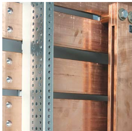
Die Lage der Hauptsammelschienen erhöht die Personensicherheit und sorgt für niedrige Innentemperaturen.
