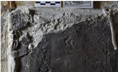
17 Vorzustand. Anböschungen von Putzrändern und Randsicherungen der Restaurierung von 1976 bis 1981.
