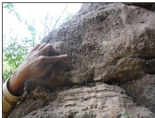
3.62 - Crostas de argila expansiva, semelhante a microtravertinos
