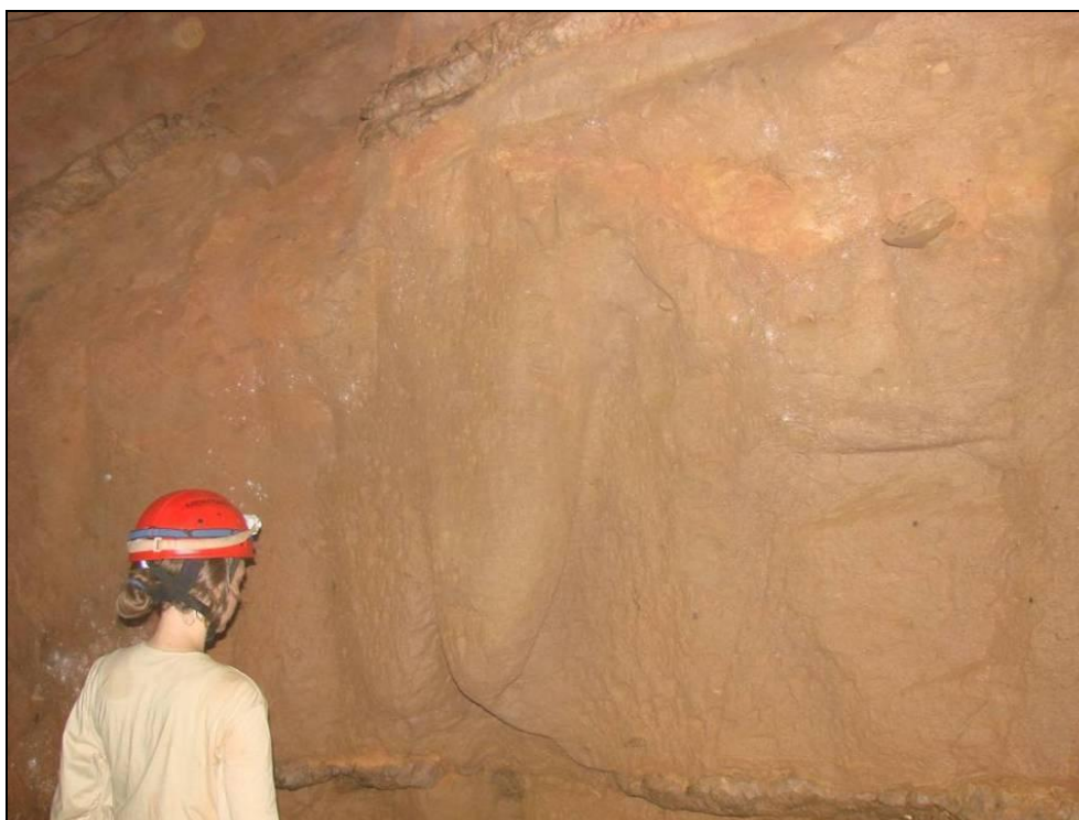
Foto 3.13 - Sulcos nas paredes causados pela percolação de água
