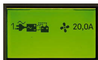
Infos zum angeschlossenen Ladegerät: Netzanschluss, Ladestrom von 20 A
