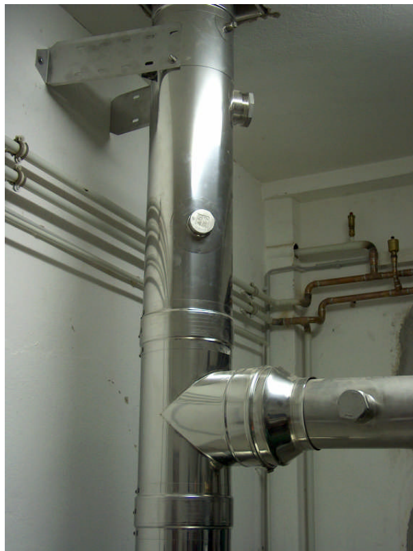
Abb. 4: Schornstein mit Messstutzen (Sonderanfertigung)
