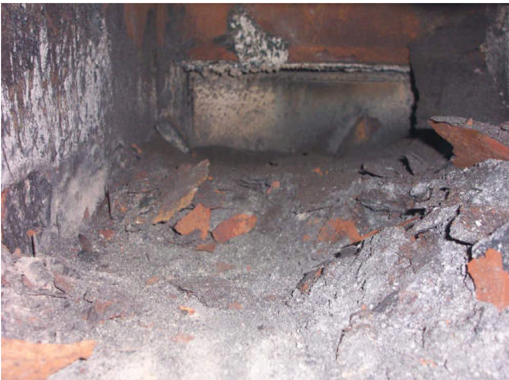
Abb. 51: Entfernte Schichtplatten am Boden des Feinstaubraumes
