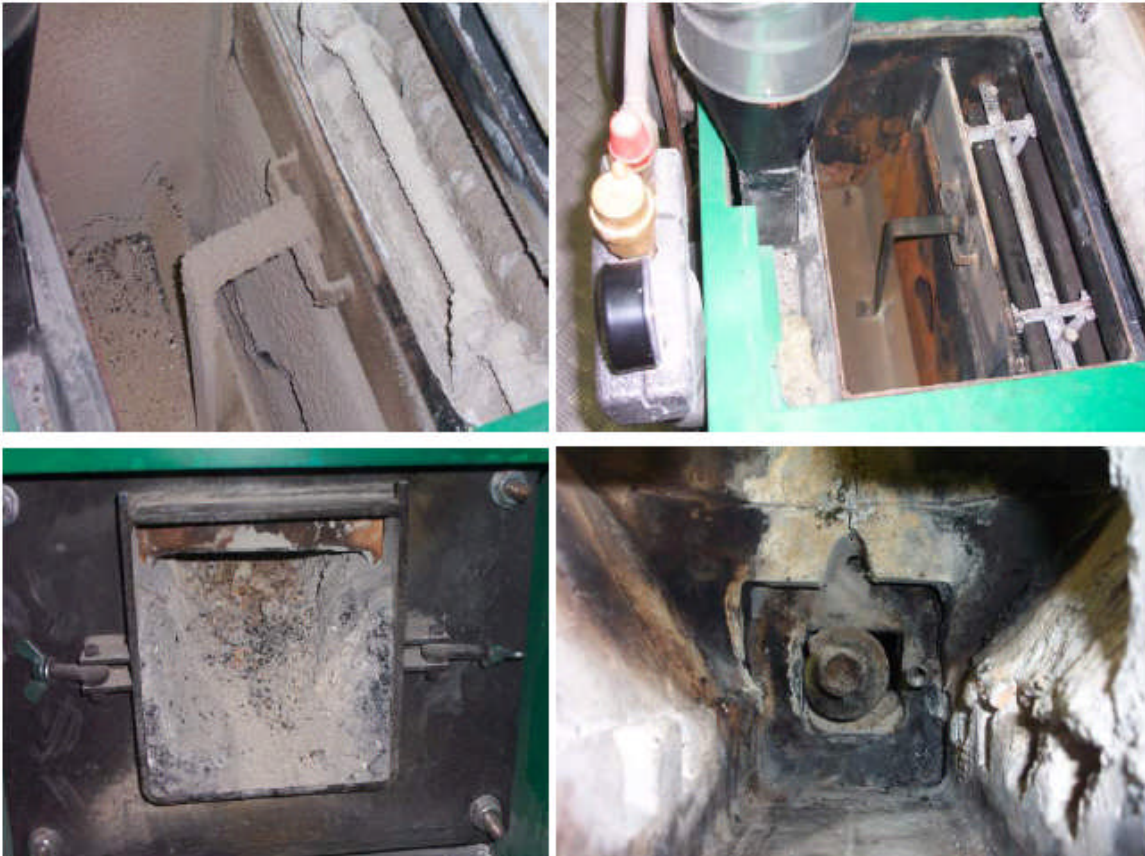
Abb. 48: Blick von oben in die Heizregister vor und nach der Reinigung
