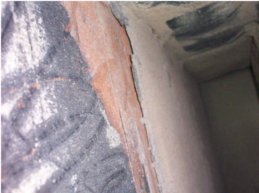
Abb. 49: Abgelagerte Staubschicht an der Seitenwand des Feinstaubraumes vor dem Abgasaustritt
